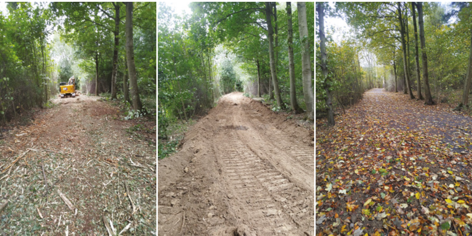
Création d'un nouveau chemin forestier : déboisement - terrassement du fond de coffre – mise en place d'un empierrement calcaire 0/300 sur géotextile – broyage et compactage - © Benoit Bernard SRL
